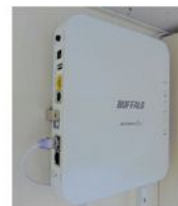
設置完了のWiFi設備
